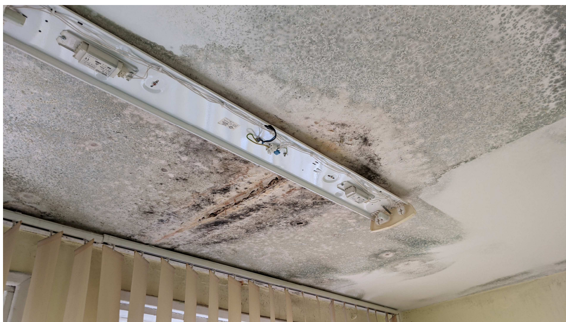
Fot.1 Stan sufitu w miejscu przecieku
