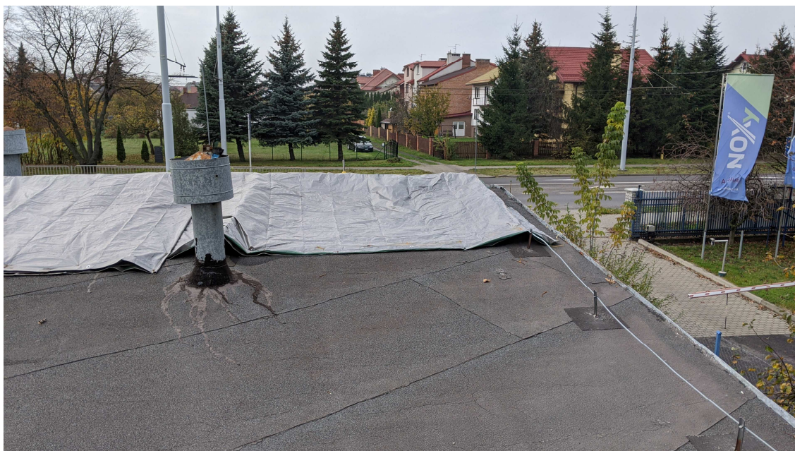
Fot.2 Prowizoryczne zabezpieczenie pokrycia w miejscu przecieku
